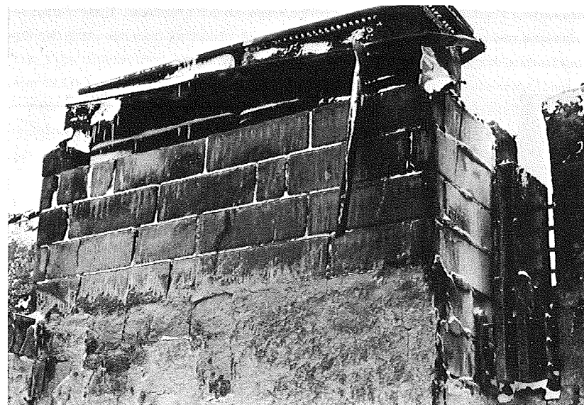
Figur 3. Gennemføring af laminerede trædragere gennem betonvæg var årsag til, at det ikke lykkedes brandvæsenet at standse branden ved branden i Stavnscholthallen i 1978.
